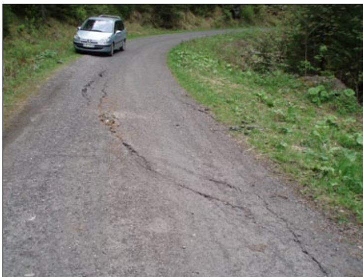
Trhliny v ceste. Foto: P. Holúbek
